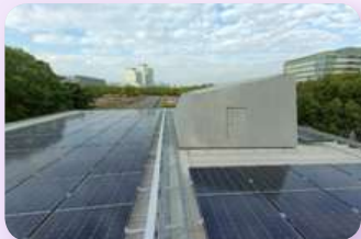
文化館屋頂太陽能板
